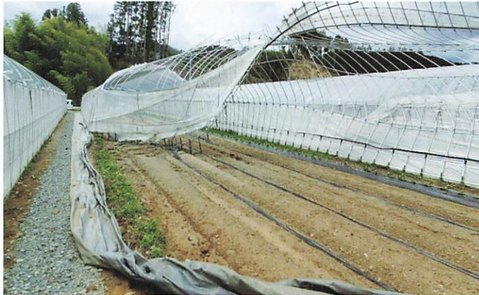
▲台風で吹き飛ばされたハウス
