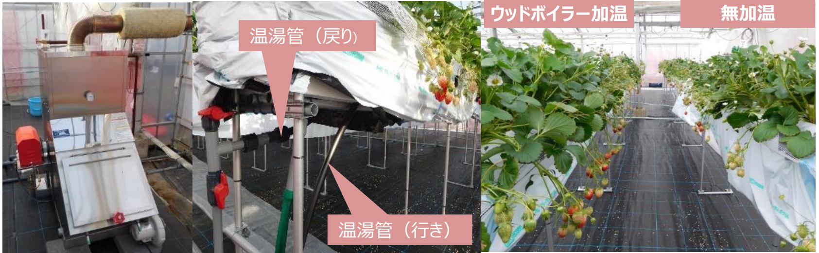
ウッドボイラー「S-220NSB」(左) 栽培槽への温湯管設置状況 (右)
